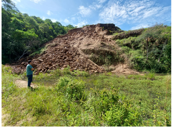
(B) Vista de uma parte do Talude desmoronando
