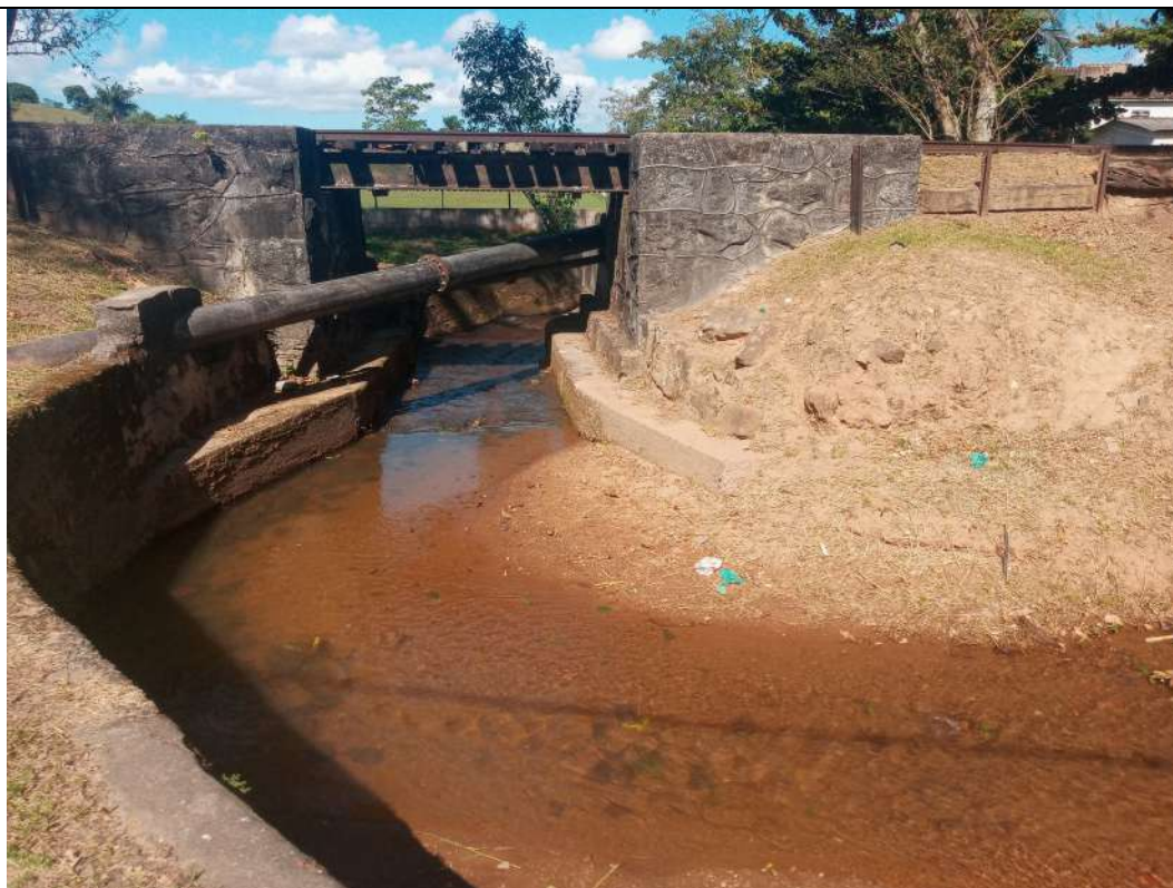
FIGURA 16: Canal Zac Zuc, às margens da Linha Férrea e Rua Humberto Marinho.
