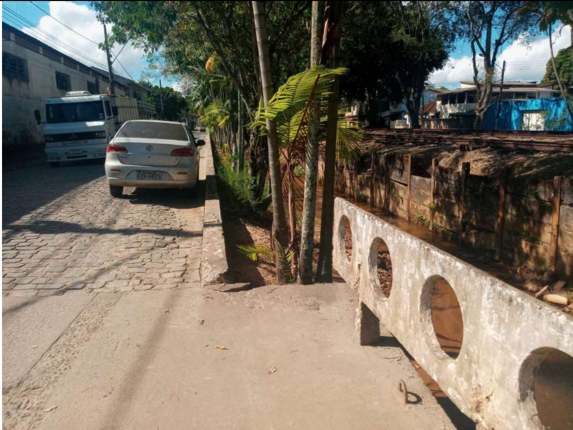
FIGURA 18: Canal Zac Zuc, às margens da Linha Férrea e Rua Humberto Marinho.
