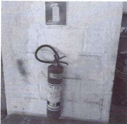
e) Extintor de incêndio
