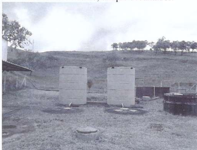
(B) Tanques Anaeróbicos, filtro biológico, poços de monitoramento, tanque decantador.
