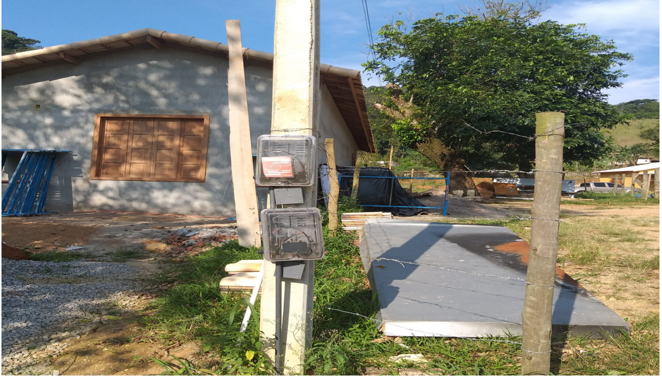
Imagem 03: Poste padrão de energia
