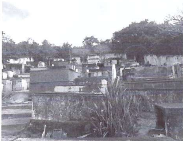
Destaque para muro danificado.
