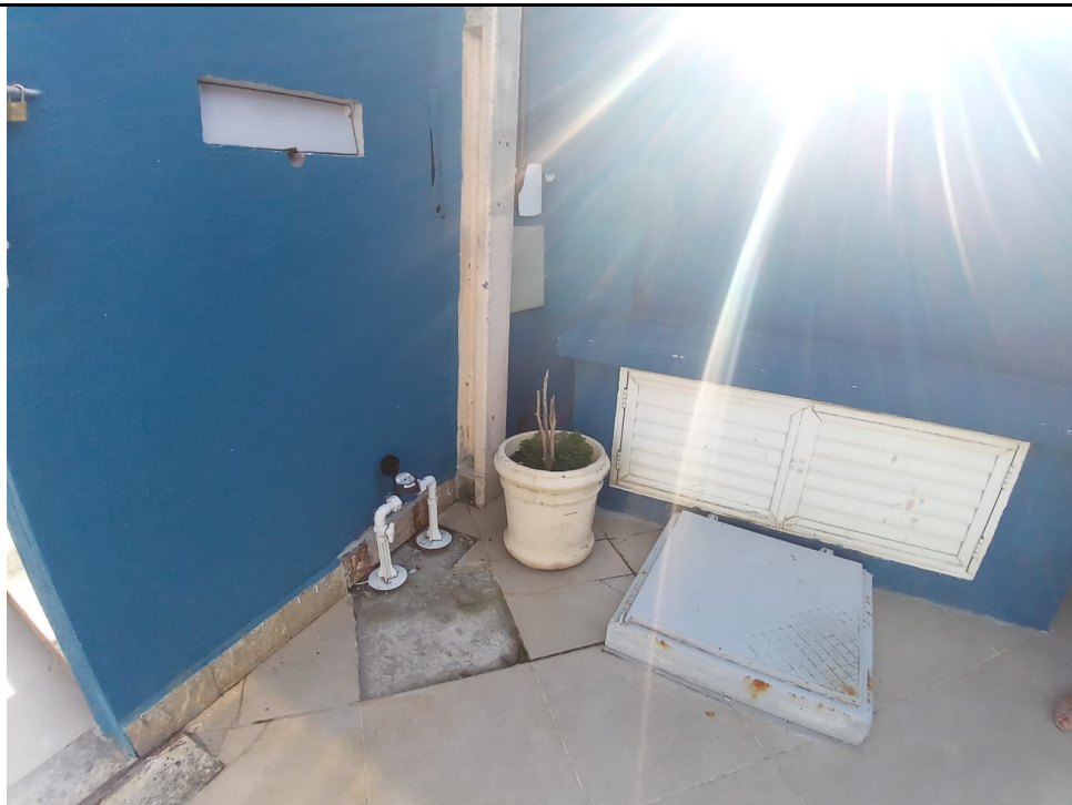
Imagem 5: Hidrômetro para abastecimento de água.
