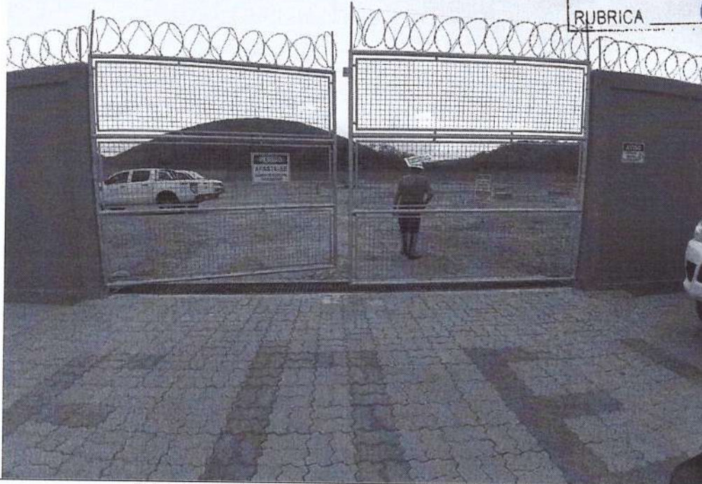
FIGURA 8: Entrada da Subestação de Casimiro de Abreu.
