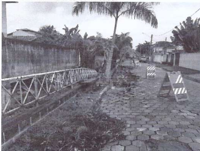
Foto 1: Vista da área danificada.
