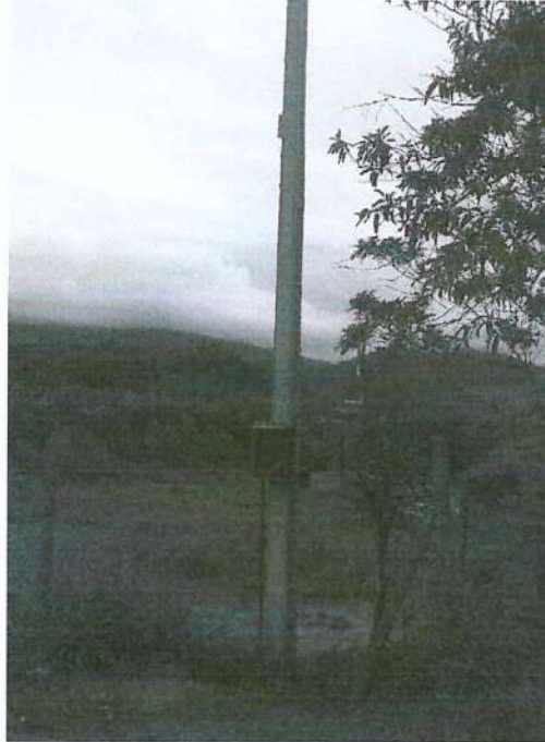
Imagem 03: Caixa de distribuição de energia
