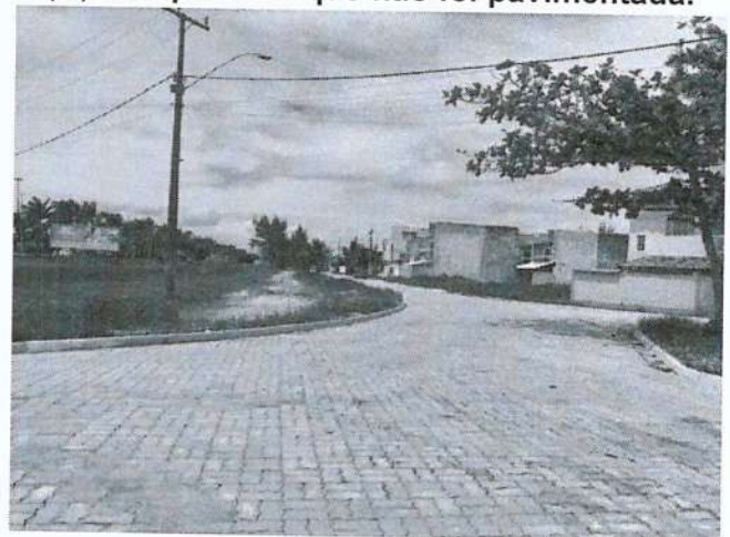
(B) Rua prevista que não foi pavimentada.
