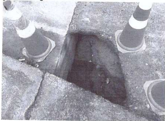
Foto 1: Fuga de material.
