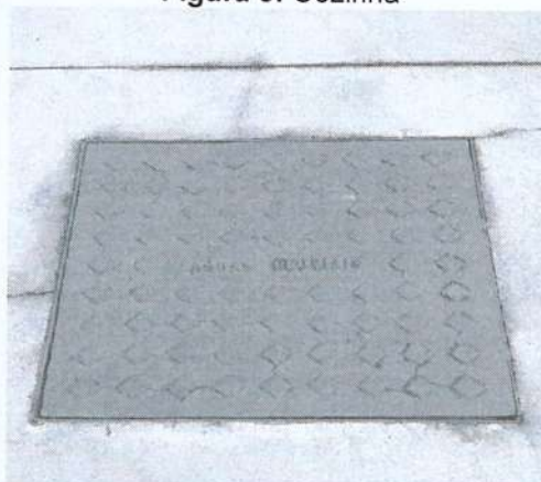
Figura 7: Caixa de passagem de água pluviais
