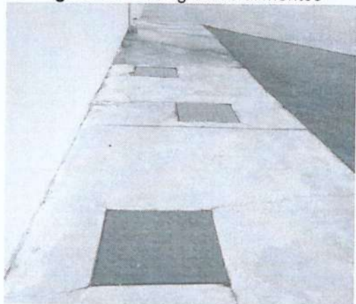
Figura 6: Caixas de passagem de esgoto e águas pluviais
