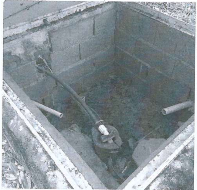
Figura 9: Bomba que capta água subterrânea
