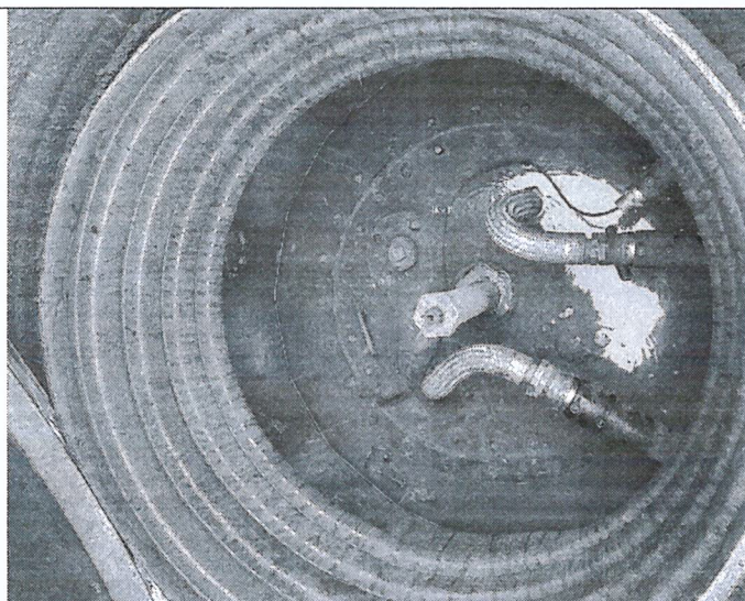
Imagem 21: Sump da boca de visita do tanque com sensor de monitoramento
