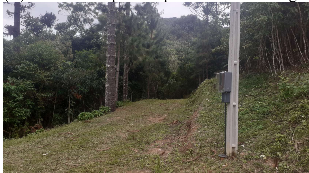
(A) Poste com o padrão que vai receber energia
