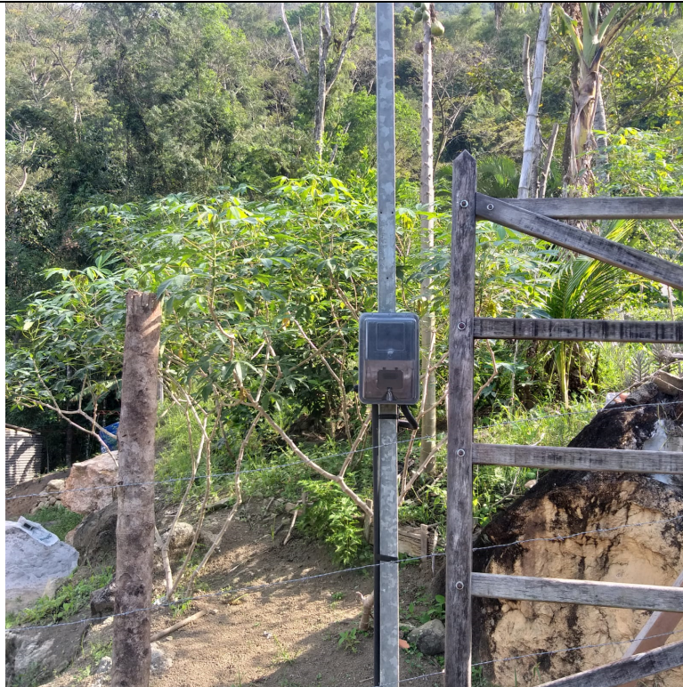
Imagem 03: Poste padrão de energia
