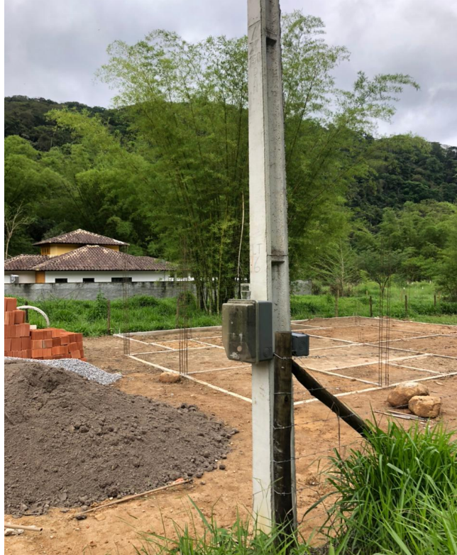
Imagem 03: Poste padrão de energia
