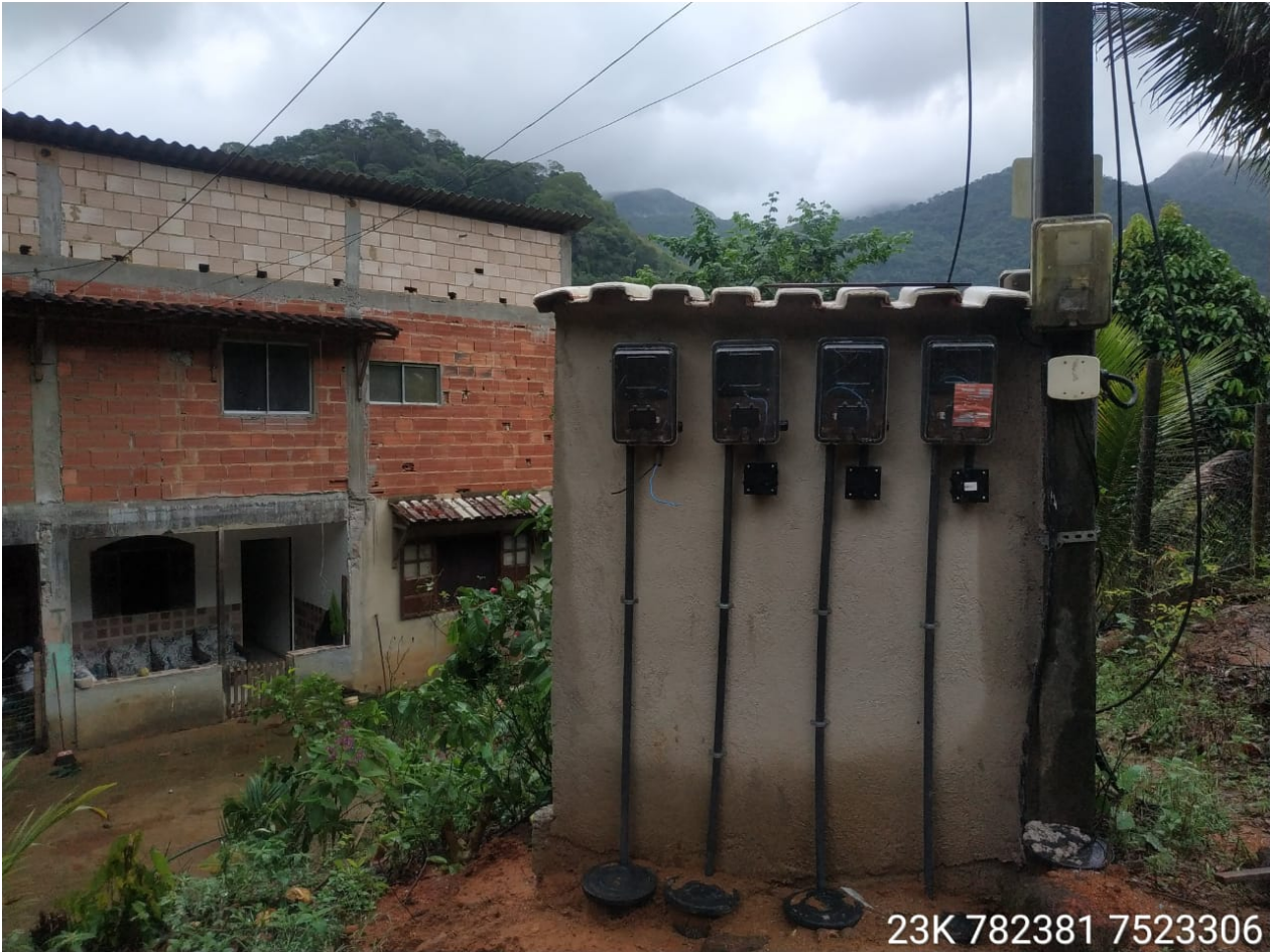
Imagem 03: Poste padrão para ligação da energia, no interior da propriedade com posteamento.
