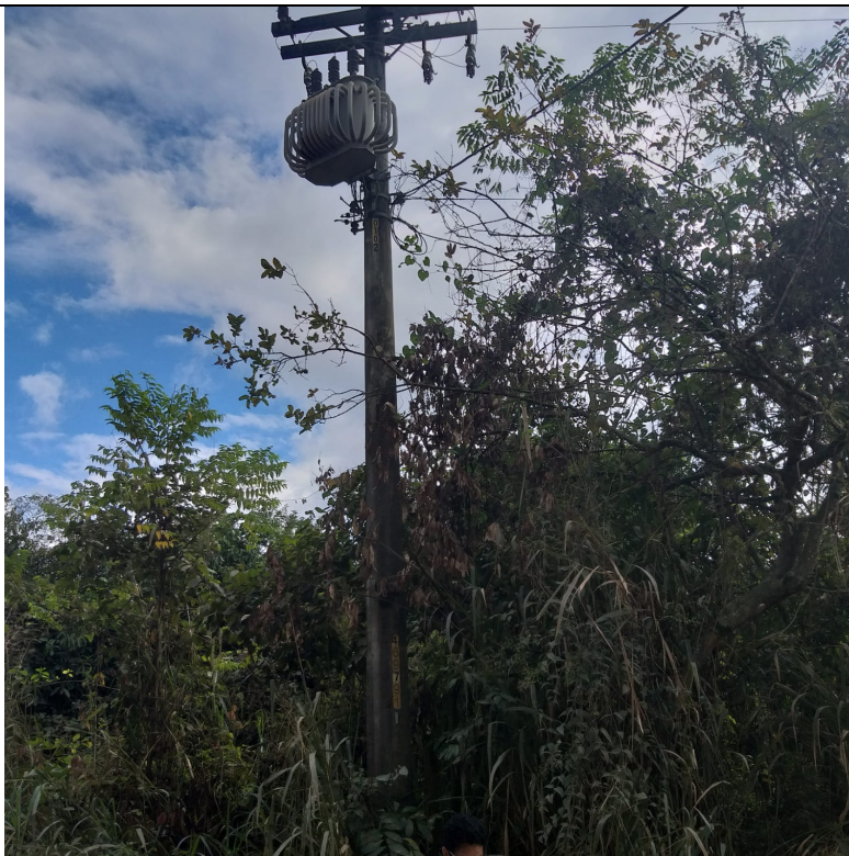
Imagem 04: Poste de energia
