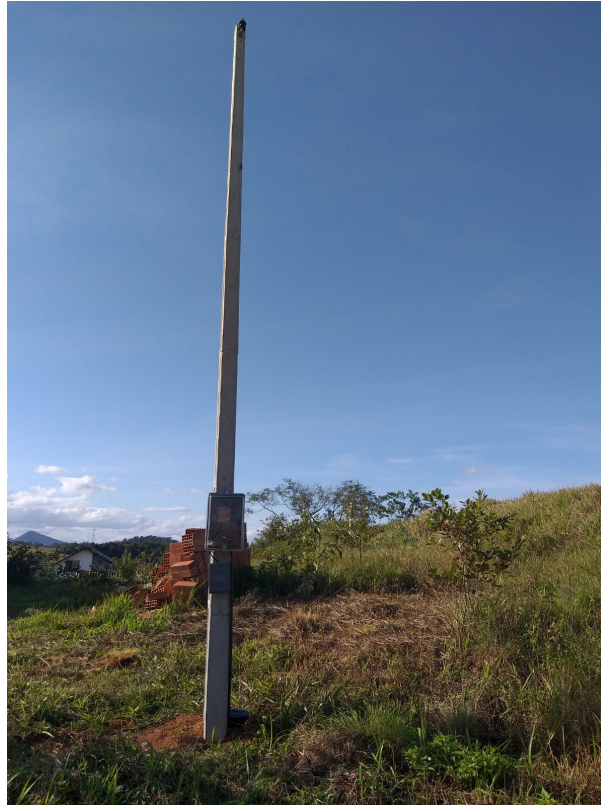
Imagem 03: Poste padrão de energia
