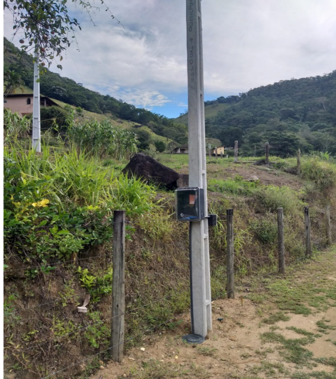
Imagem 03: Poste padrão para ligação da energia, no interior da propriedade com posteamento.
