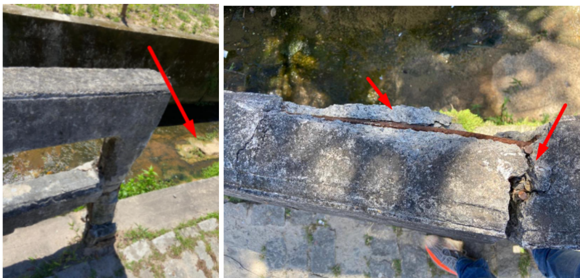
Foto 5 - Guarda-corpo de concreto danos estruturais
