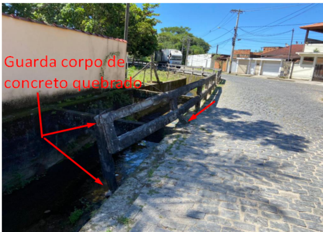
Foto 3 –Guarda-corpo de concreto danificado
