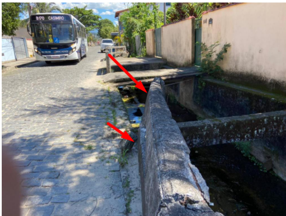
Foto 2- Início do guarda-corpo de concreto danificado
